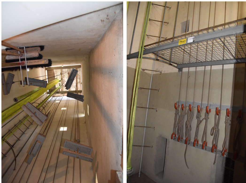
Abb. 7.3-37: OF Neusüdende: Feuerwehrschräuche im Schlauchtrockenturm (linkes Bild)
