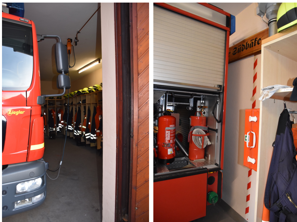
Abb. 7.3-41: OF Südbäke: PSA in der Fahrzeughalle (links)
