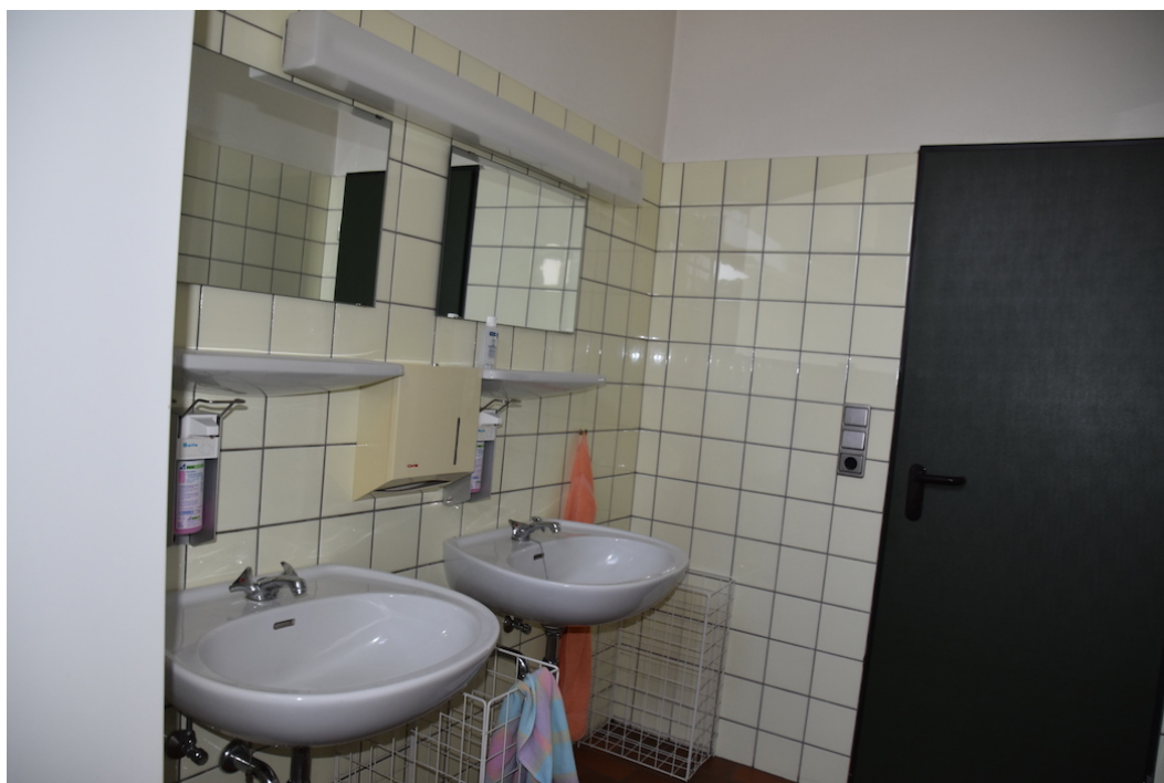
Abb. 7.3-29: OF Loy-Barghorn: Sanitäranlagen
