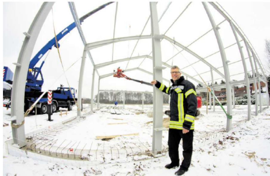
Stahlgerippe: Ortsbrandmeister Uwe Hilgen ist stets bestens über den Baufortschritt des neuen Feuerwehrhauses der Feuerwehr Friedrichsfehn in Kleefeld informiert.
